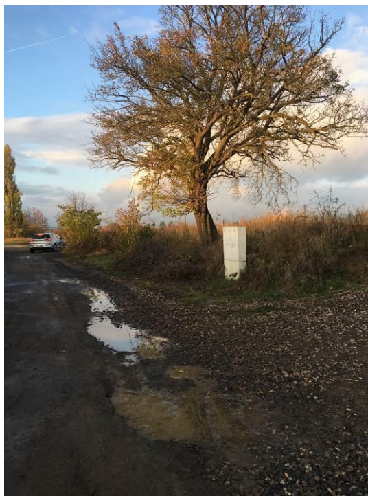
rozvodná skříň – nutná přeložka
